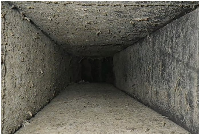
Conduit de ventilation ayant besoin d'entretien
