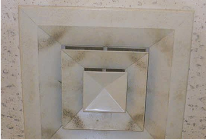
Bouche de ventilation ayant besoin d'entretien
