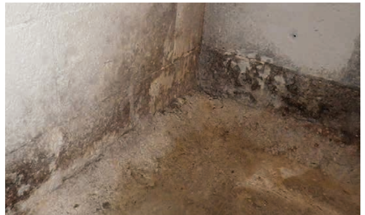
Moisissures dues à un excès d'humidité dans le sous-sol
