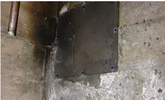
Efflorescence et cernes d'humidité dans un sous-sol
