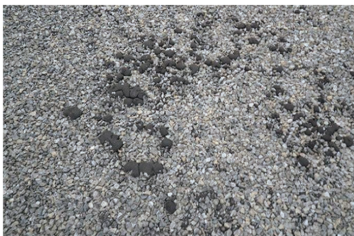
Bulles d'asphalte en surface
