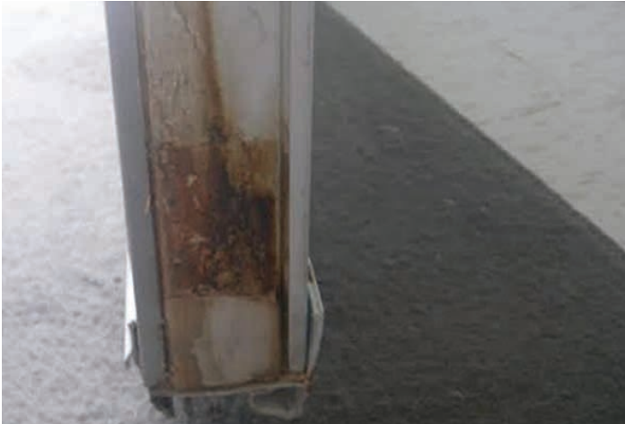
Traces d'humidité sur une porte
