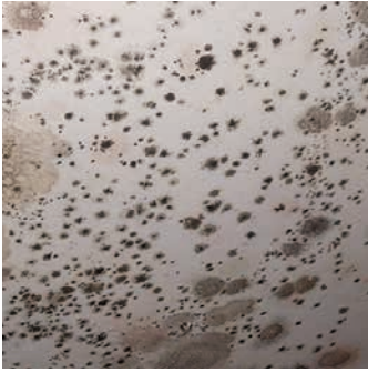
Plafond recouvert de moisissures
