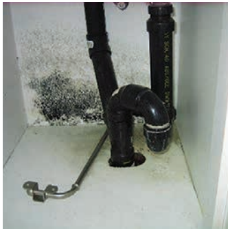
Dessous d'évier avec moisissures
