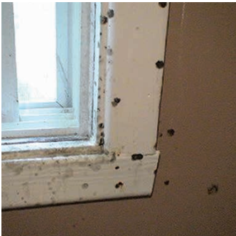
Cadrage de fenêtre avec moisissures
