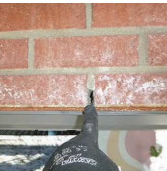
Chantepleure partiellement obstruée
