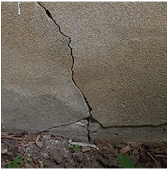
Fissure dans la fondation
