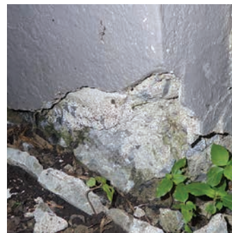
Dégradation d'un coin de fondation
