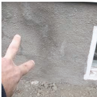
Cernes d'humidité sur une fondation
