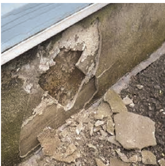
Dégradation du crépi
