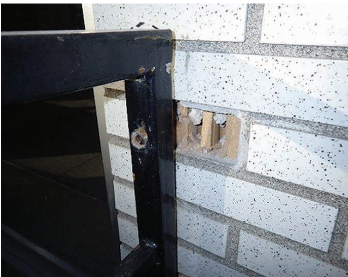
Garde-corps mal fixé au mur extérieur
