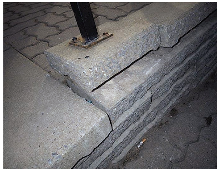
Garde-corps mal fixé au sol
